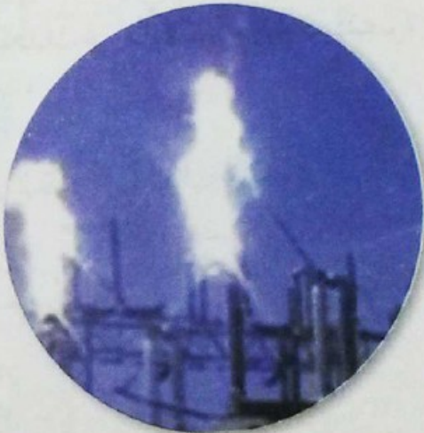
حريق في أسلاك توصيل
